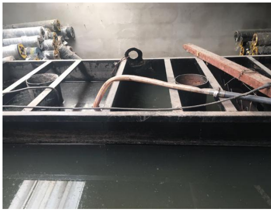
污水处理设施
