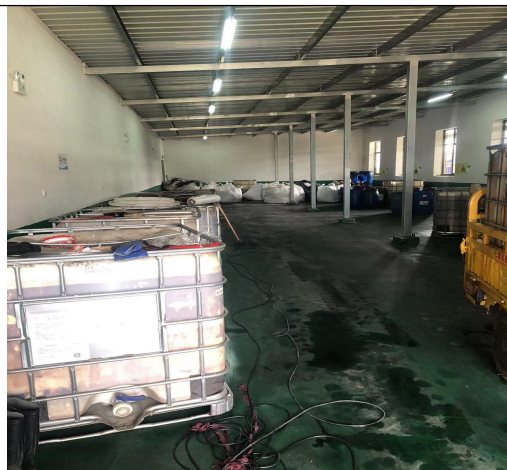
地面防渗及防爆照明灯
