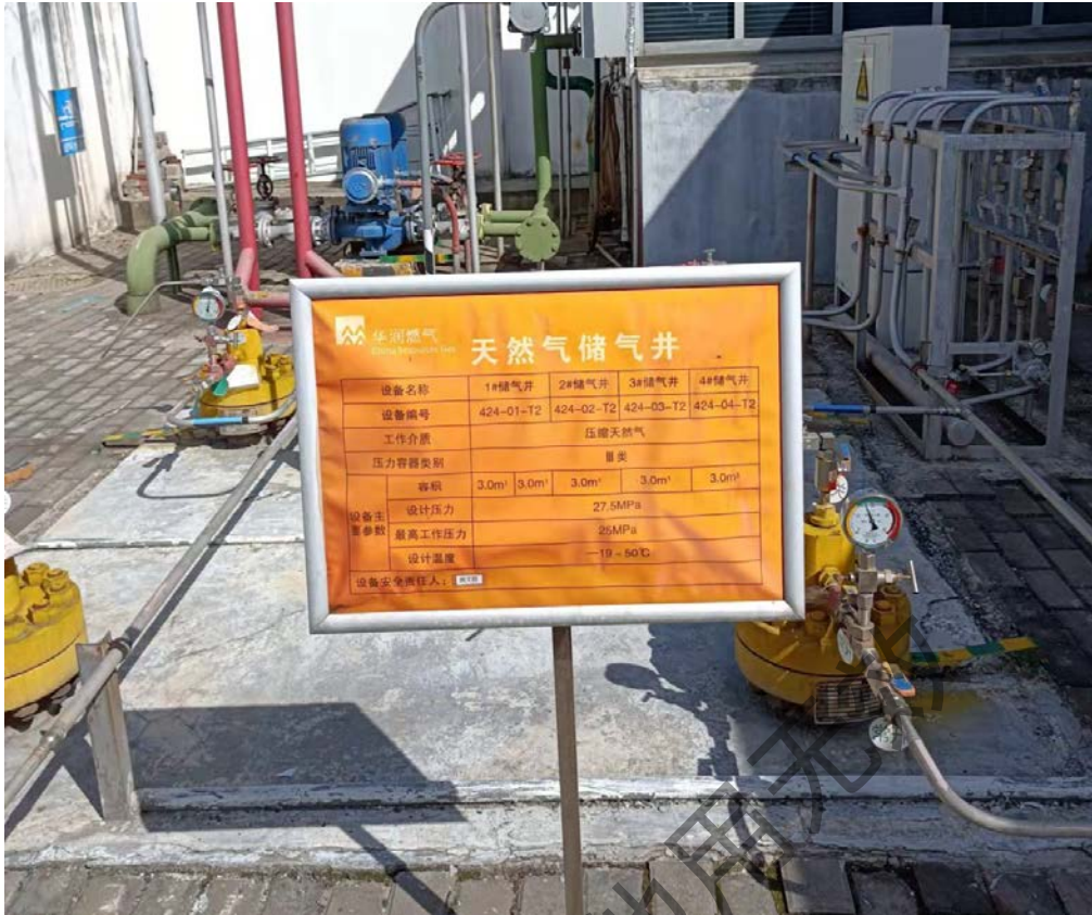
图 2.4-5 华润天然气加油站地下搅拌罐设施
