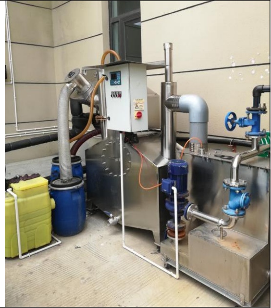
食堂废水处理设施
