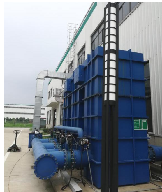
滴漆废气处理设备（蓄热燃烧系统）
