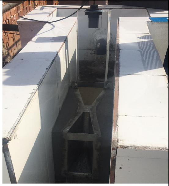
废水排放口阀门
